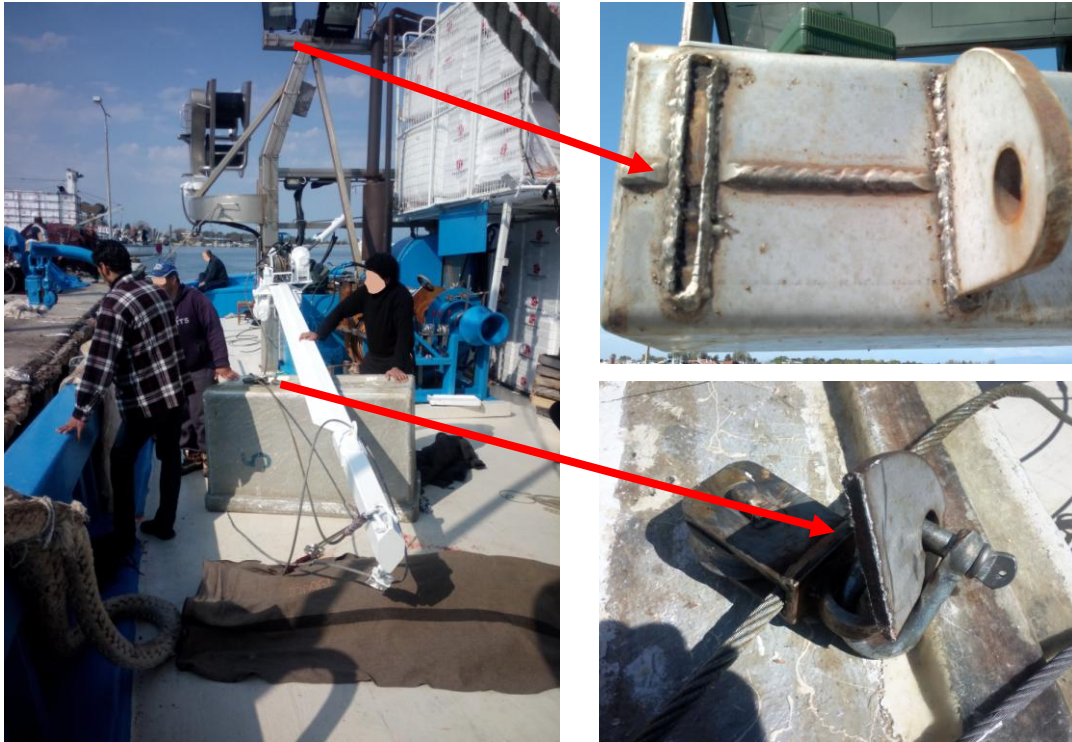
Εικόνες 3.3.3/1, 2 & 3: 1. Εικόνα του βραχίονα του γερανίσκου μετά από το ατύχημα και η θέση του θύματος μετά από αυτό, 2. Εικόνα της περιοχής συγκόλλησης του ωτίου (μάπας) που αποκολλήθηκε, 3. Εικόνα του ωτίου για τον οδηγό συγκράτησης του συρματοσχοίνου ανύψωσης του βραχίονα..
